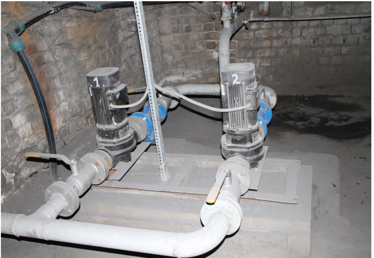
Внешний вид насосной группы котельной
